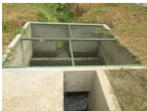
Décanteur-séparateur mis en place pour traitement des eaux de garage avant écoulement vers l'extérieur
